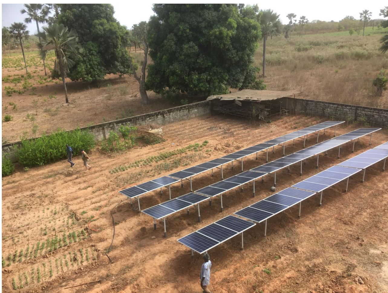
Pannelli solari fotovoltaici che alimentano la pompa solare per l'acquedotto di Oulampane
