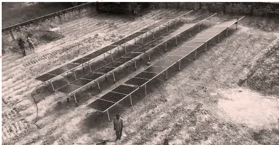
I nuovi pannelli fotovoltaici che alimentano la pompa solare dell'acquedotto di Oulampane
