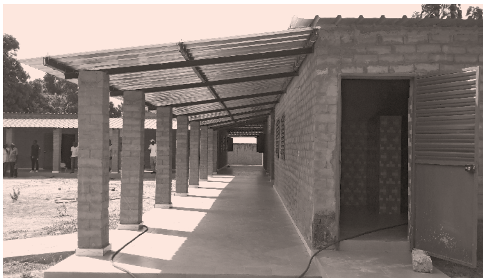
La struttura è stata realizzata in mattoni ecologici di produzione locale, in argilla con un minimo contenuto di cemento e realizzati con una pressa manuale
