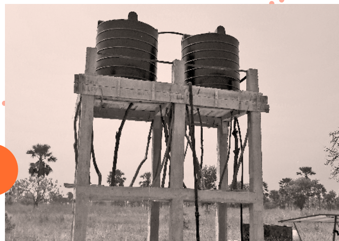
I due serbatoi di acqua alimentati dalla pompa solare del terreno di Silinkine
